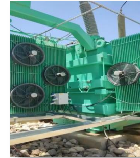
Activación de moto ventiladores
