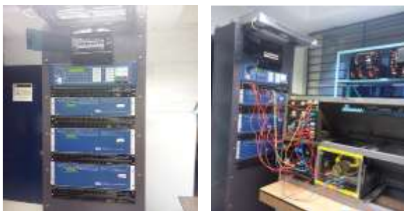
Figura 1. Relevadores Digitales de protección con detección de fallas de alta velocidad
