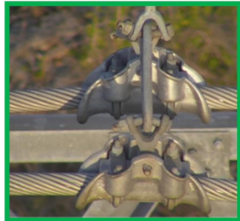
Fig. 4 Revisión y determinación de Del estado que guardan conductor y clemas o herraje de suspensión
