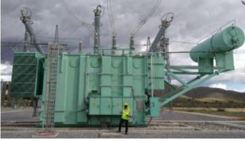
Fig. 3. Fotografía de un transformador de potencia de 120 MVA.
