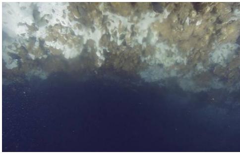
Fig. 5. Detalle de incrustación en la parte superior de la tubería
