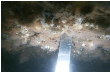
Fig. 7. Obtención de espesor de acumulación de incrustaciones
