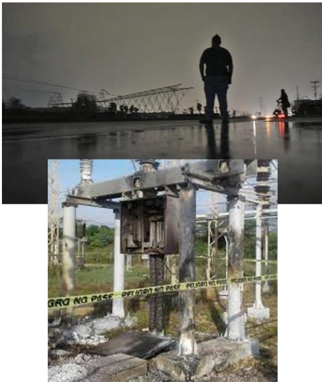
Figura 8. Daños ocasionados durante el paso de un ciclón tropical.
