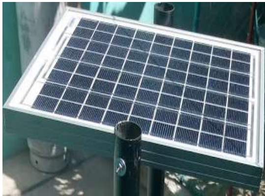
Fig. 5. Panel solar del arreglo experimental.
