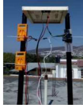
Fig. 6. Instalación del panel solar al aire libre.
